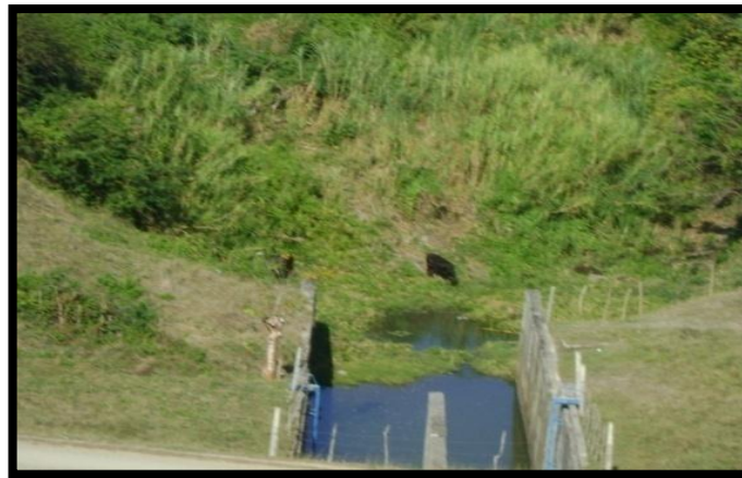
Figura 31. Acumulación de tierra en el canal.
