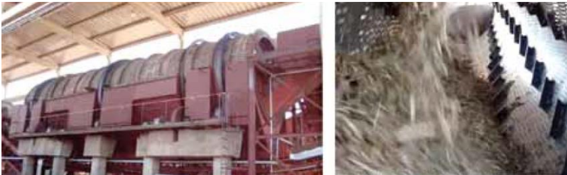
Figura 6 Equipo para la limpieza en seco de los RAC. Separación de tierra y piedra
