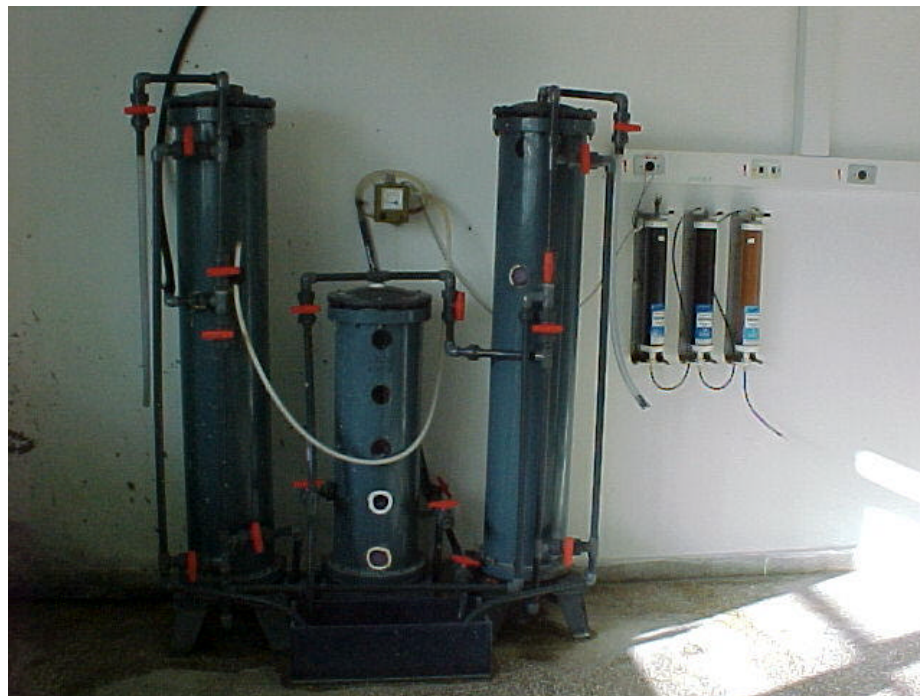
Figura 5: Unidad de Desionizadora de Agua.
