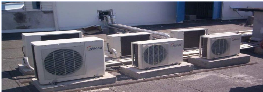
Figura 2.4: split Midea en cubierta de los Bungalows
