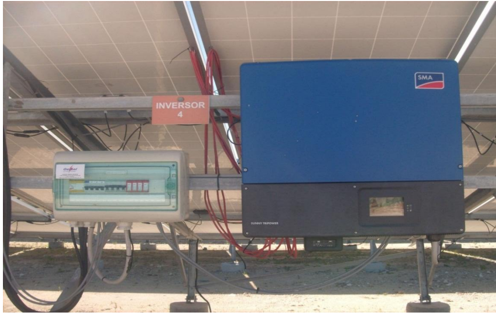
Figura 2.1. Inversor SMA de 17kW.
