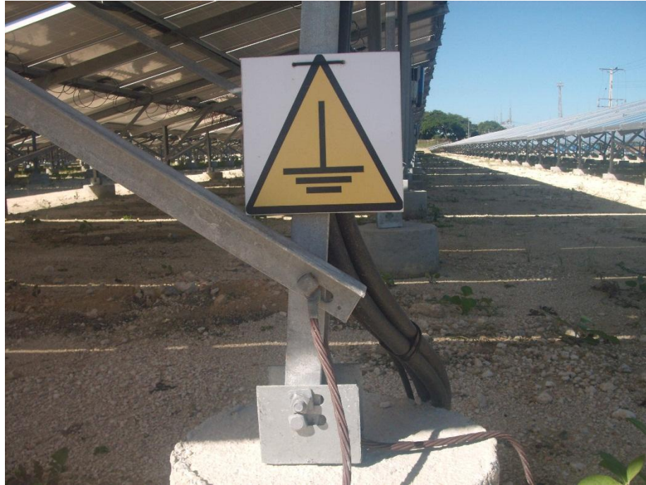
Figura 2.10. Punto de conexión de la hilera de tableros con la malla de tierra.
