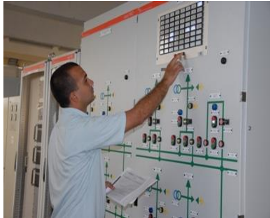
Figura 8: Sala de control de la Subestación
