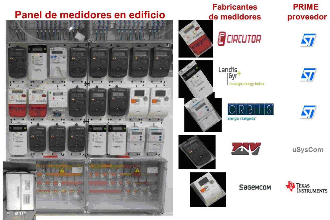
Figura 13: Equipos de medición y comunicación en un panel.
