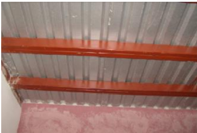
Fig. 1. 2 Sistema de canaleta y aluzinc.
