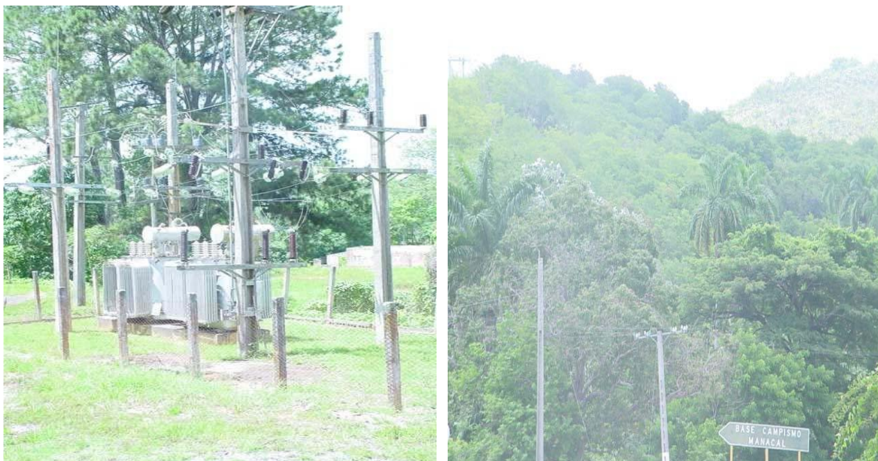
Figs. 9 y 10. Líneas eléctricas Topes de Collantes. Fuente: E prensa.
