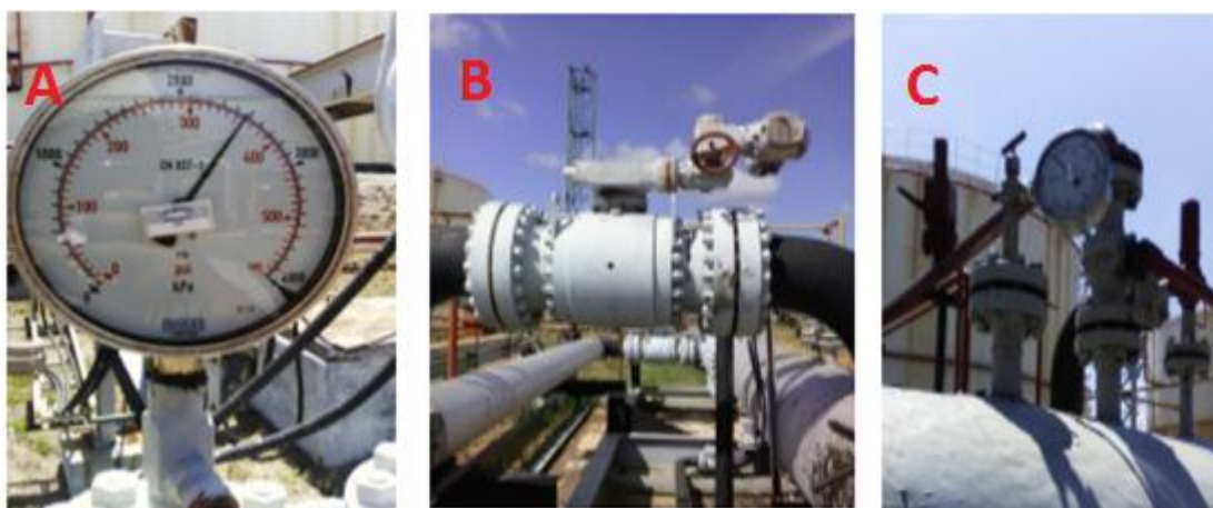
Figura 2.1 a) Manómetro que se encuentra en la tubería de salida, b) Conjunto válvula-motor-actuador, c) Manómetro ubicado en el tambor de lanzamiento del rascador.
