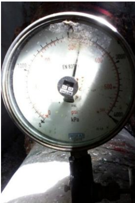
Figura 2.21: Manómetro de la entrada.
