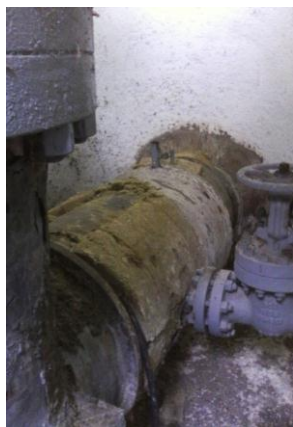
Figura 2.26: Toma de presión sin manómetro.
