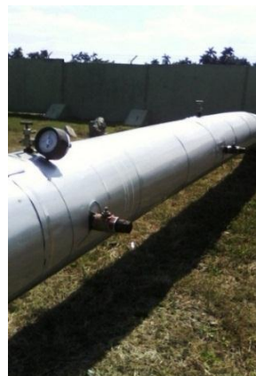
Figura 2.4: Tubería sin válvula.
