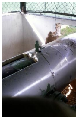
Figura 2.9: Toma de presión sin manómetro.
