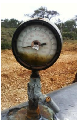
Figura 2.11: Manómetro de la entrada.
