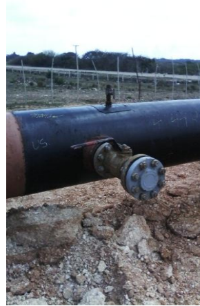
Figura 2.14: Toma de presión sin manómetro.
