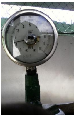
Figura 2.8: Manómetro de la entrada.
