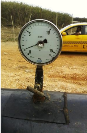
Figura 2.13: Manómetro de la entrada.
