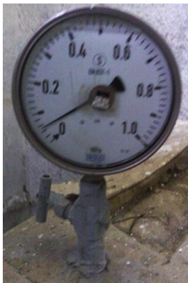
Figura 2.28: Manómetro de entrada.
