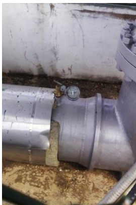
Figura 2.5: Manómetro de la entrada.
