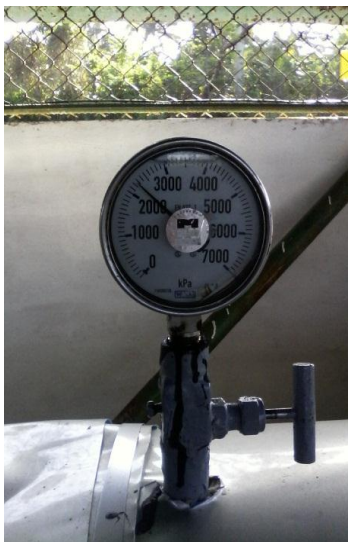
Figura 2.17: Manómetro de entrada.
