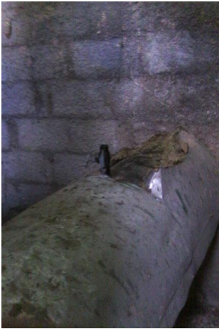
Figura 2.23: Toma de presión sin manómetro.
