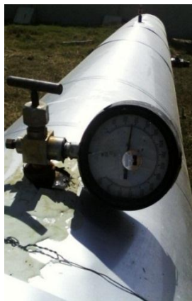
Figura 2.3: Manómetro colocado en la tubería.
