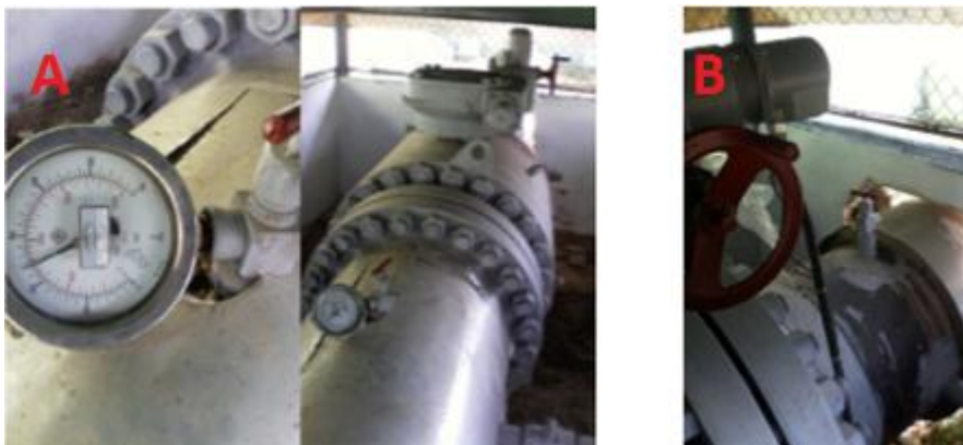
Figura 2.7 a) Manómetro de entrada, b) Toma de presión a la salida.
