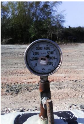
Figura 2.15: Manómetro de la entrada.
