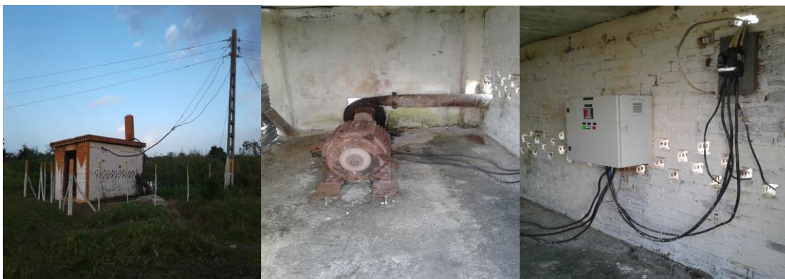
Figura 4. Estacion de bombeo, motor e intalación eléctrica
