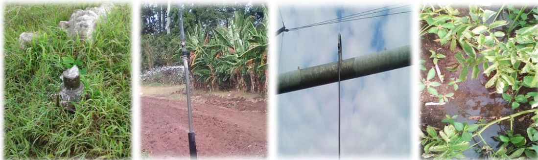
Figura 6. Salideros en hidrante, tubería principal y bajante
