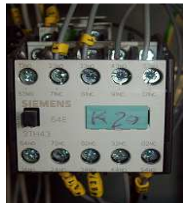
Figura 7. Relé Secuencia Descarga
