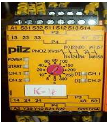
Figura 5. Relé Parada de Emergencia
