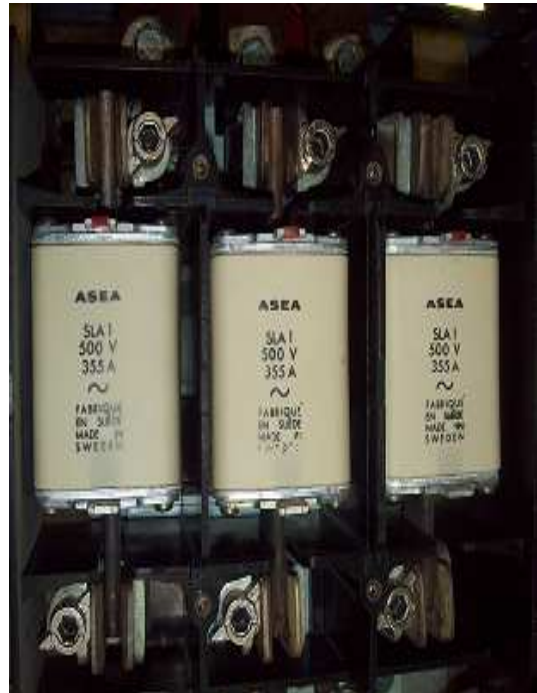
Figura 2. Fusibles de Entrada
