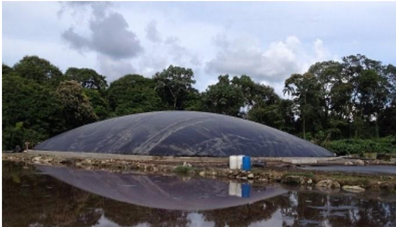
Figura 1.4 Laguna anaeróbica cubierta
